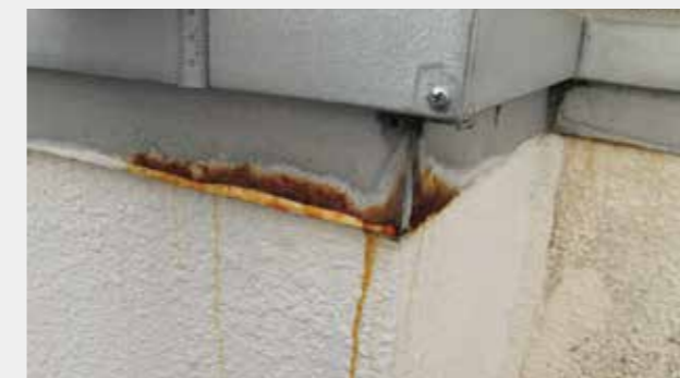
コンクリートとの接触による腐食事例
