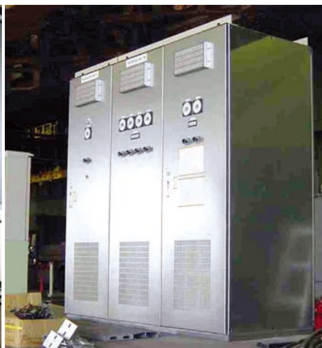
金属加工 東日本製鉄所 君津地区 (制御盤)
