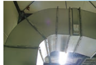
ダクト/中部国際空港旅客ターミナルビル
