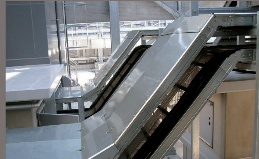
ケーブルラック
