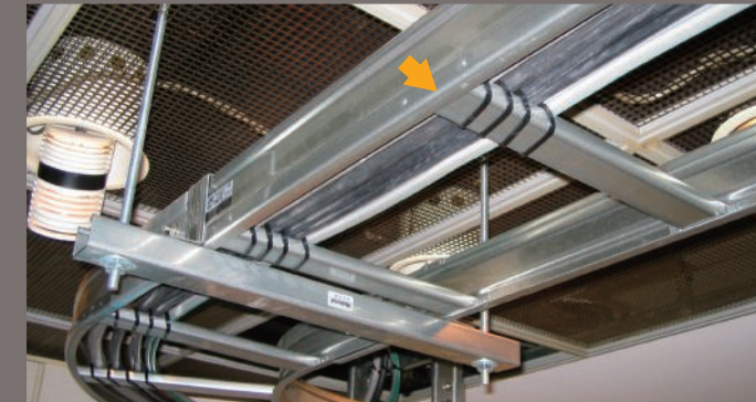
ケーブルラック
