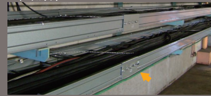
ケーブルラック
