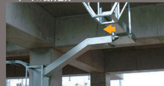
▲ ケーブルダクト
