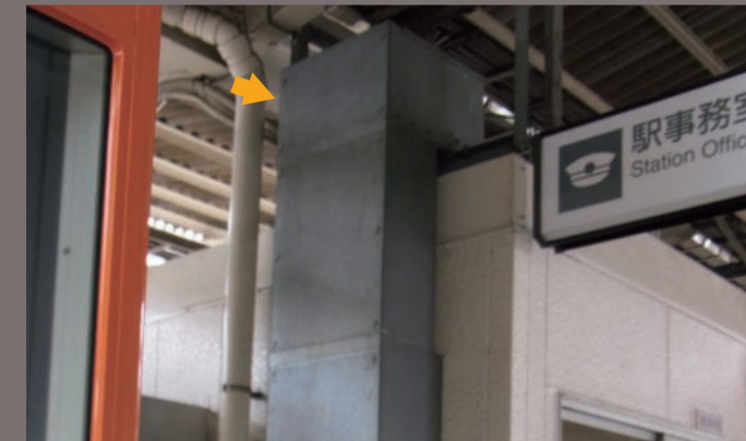
ケーブルラック
