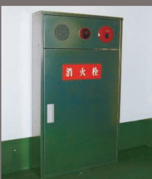
消火栓ボックス
