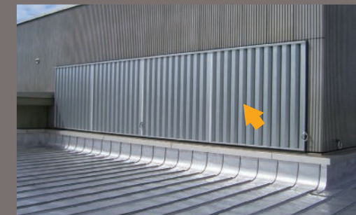
▲ 遮音ルーバー
