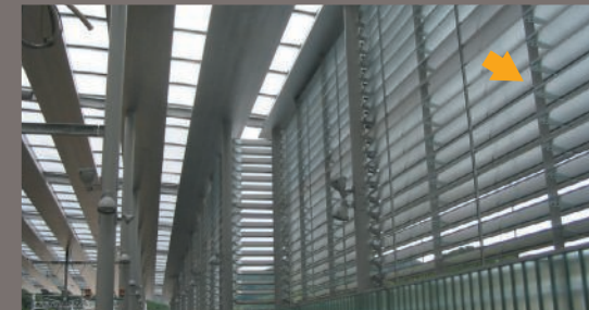
▲ 遮音ルーバー (駅舎)
