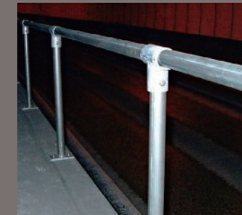
▲ トンネル内ハンドレール
