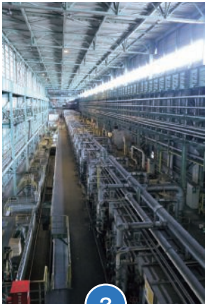
2 焼鈍炉 (横型ラジアントチューブ炉)
