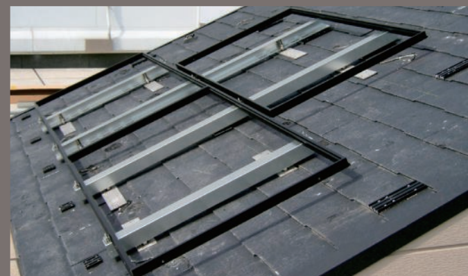
太陽光発電モジュール架台
